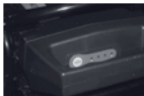
Kapacitetsindikator med LED-lamper på batteriet.
